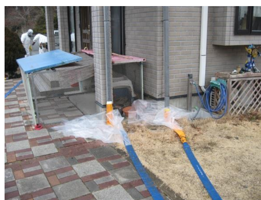
屋根瓦の洗浄水を雨樋から回収
